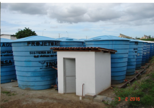
Reservatórios e casa de bombas
