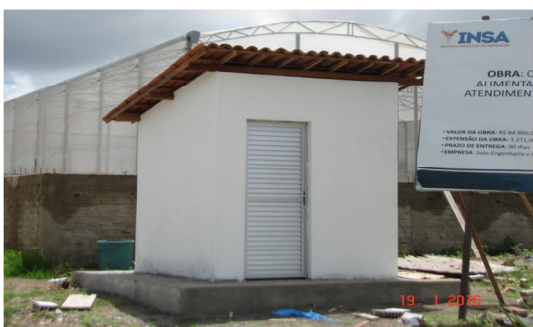
Casa de bombas para casas de vegetação
